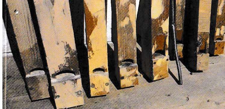
důsledky starších provizorních oprav
